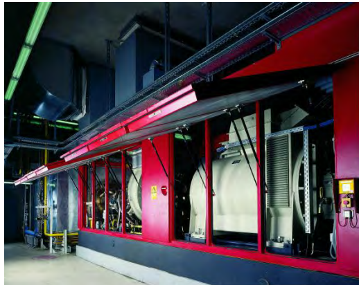
Gasturbinen 2 x 4 MW el
