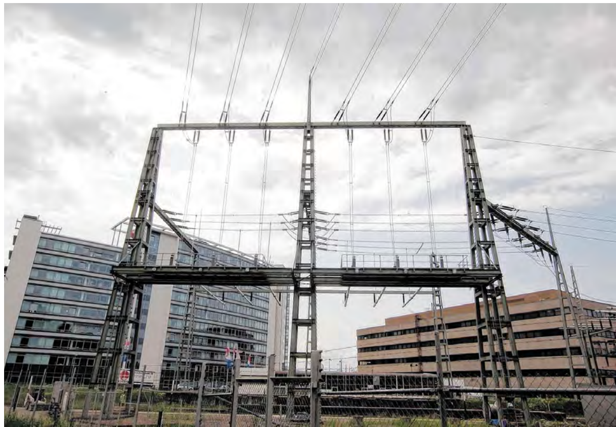
Umspannwerk Feuerbach: Die Stadt Stuttgart will die Stromversorgung bald wieder in eigener Regie übernehmen. FOTO: SCHMIDT
